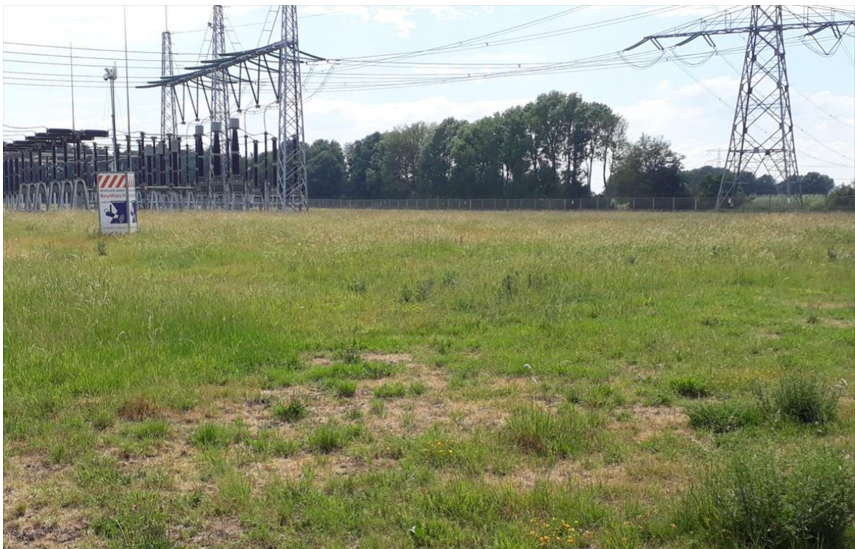
Figuur 1: Het 380 kV station Dodewaard in juni 2020. De kwaliteit van het grasland is toegenomen en kan warme jaren als 2018-2019 goed doorstaan.
